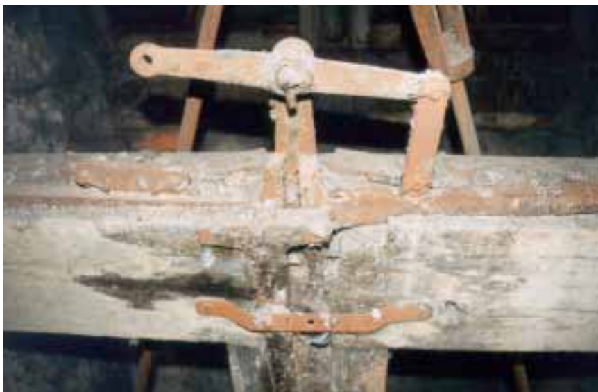
Obr. 9. Dřevěná zvonová stolice a takzvané rohaticy v severní věži kostela sv. Jana Nepomuckého na Skalce v Praze na Novém Městě. Pohled shora na zavěšení na rohaticích. Jsou vidět čelisti svírající čepy závěsu zvonu. Čelisti se pohybují nahoru a dolů a jsou spojeny vahadlem. Takové součásti dobového uložení zvonu je třeba považovat za technické řešení zasluhující – zvláště pokud je zachováno v provozu se zvonem – pozornost památkové péče.
