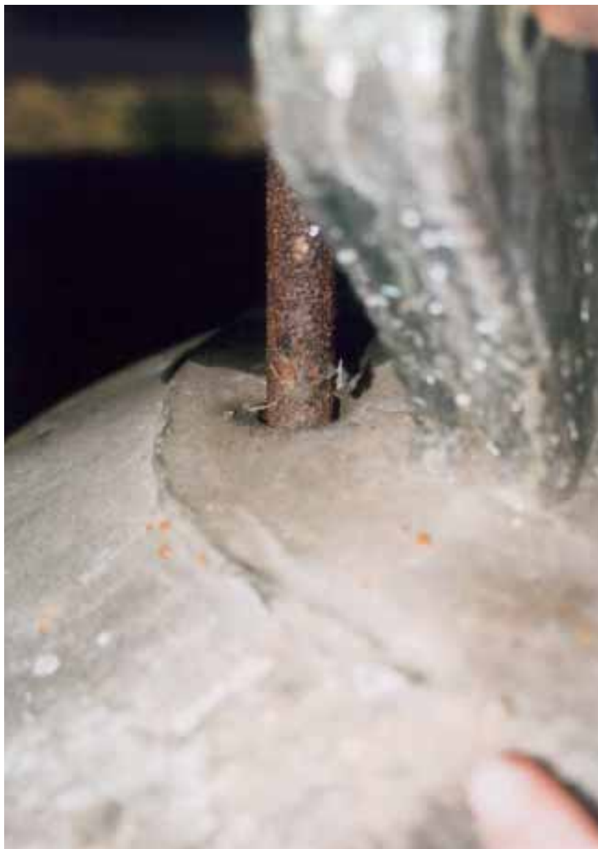
Obr. 7. Příklad provrtání čepce. Jde o zásah do hmoty zvonu, který nesmí být připuštěn.
